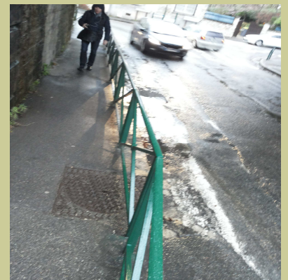
Flaque d'eau et éclaboussures sous le pont de la gare
